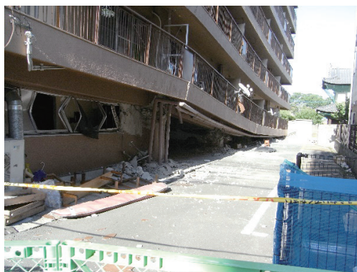
写真2 1層崩壊(熊本地震)
