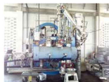
パイロットプラント
