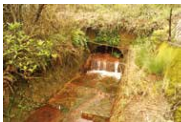
写真-6 福岡県鞍手町泉水の抗排水
