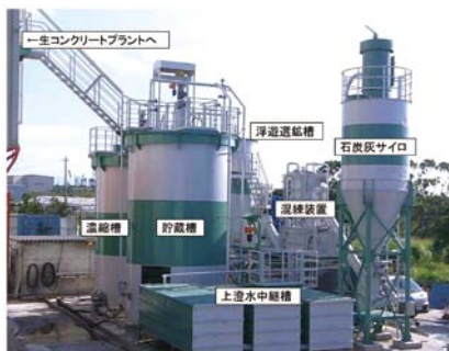
写真4 改質フライアッシュ実機プラント(沖縄県:E-CON社)
