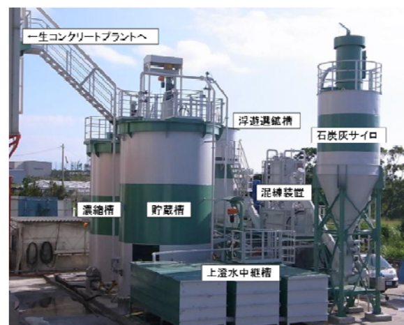
写真3 改質フライアッシュ実機プラント (沖縄県:E-CON社)
