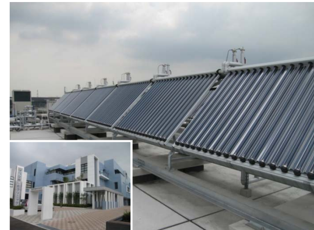
給湯負荷の大きな病院に設置された太陽熱集熱システムの性能評価(北九州市)
