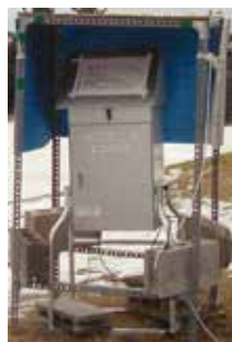
写真3 大気中(汚染)物質(気体や粒子状物質)を連続的に採取する装置の外観
