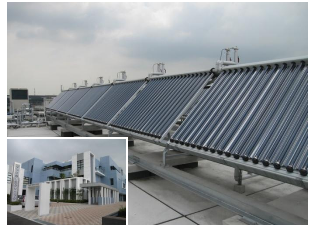
給湯負荷の大きな病院に設置された太陽熱集熱システムの性能評価(北九州市)
